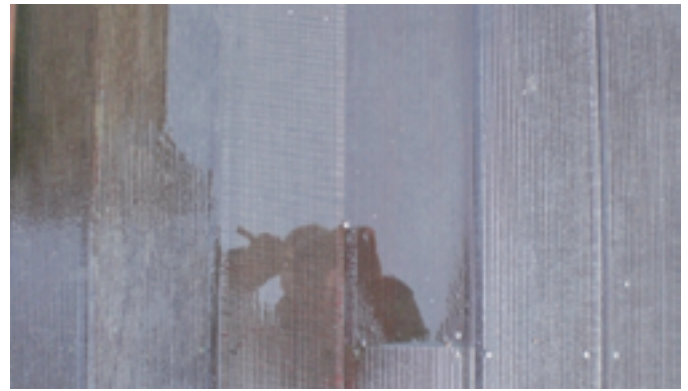
Ohne ausreichende Fugenabstände sind die Fugen oftmals nicht mehr vorhanden.
