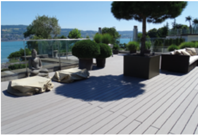
Große Blumenkästen müssen schon bei der Planung berücksichtigt werden insbesondere bei Aufdachdämmungen.
