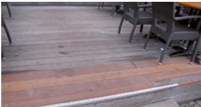
Bei stark genutzten Flächen kann ein Austausch erforderlich werden.
