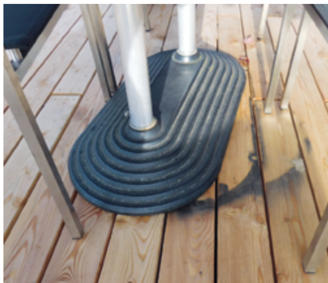
Verfärbung durch Tischuntergestell aus Metall bei Lärche.
