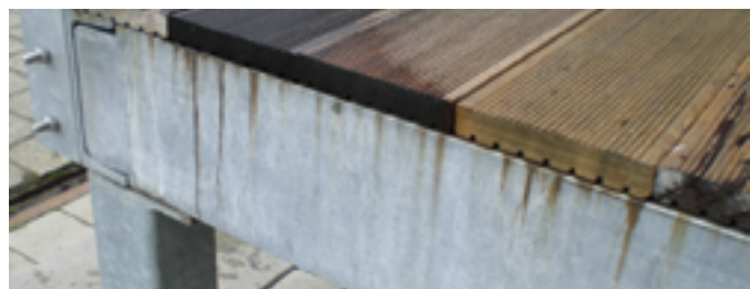
Auswaschungen aus Bangkirai, die sich nur durch eine konstruktive Lösung verhindern lassen.
