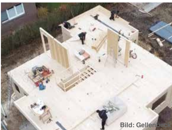
Abb. 8 Bautenstand am Nachmittag. Die Decke ist verlegt und die Montage des Obergeschosses beginnt.
