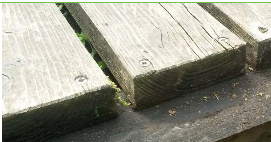
Abb. 1: Deutlich ausgeprägte Endrisse bei einer Terrassendiele.
