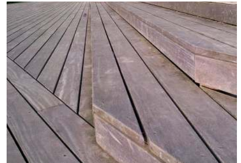
Abb.2: Sichtbar wird die holztypische Eigenschaft des Schwindens und Quellens an unterschiedlichen Fugenbreiten im Sommer und Winter. Bild: Ing.-Büro Holger Meyer
