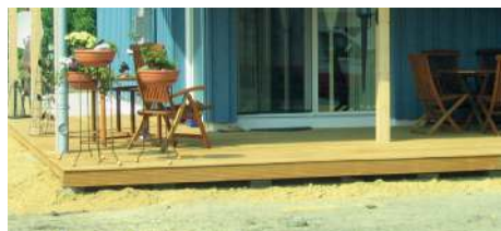
Abb. 5: Seitliche Abschlüsse bei Holzterrassen reduzieren in starkem Maße die erforderliche Belüftung (vgl. Abb. 3). Die Fugenbreiten sind ausreichend zu bemessen.
