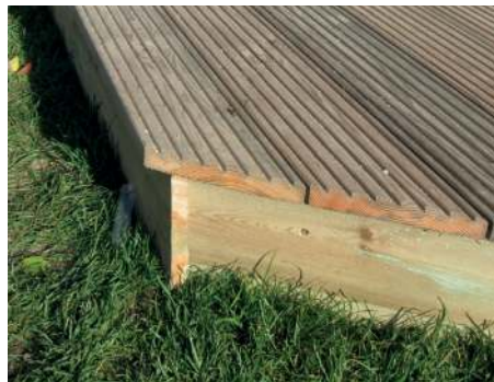
Abb. 12: Häufige Ausführung mit seitlichem Abdeckbrett. Der Hohlraum wird bis auf die Fugen zwischen den Dielen verschlossen. Diese Variante ist im Hinblick auf die Lebensdauer sehr ungünstig.
