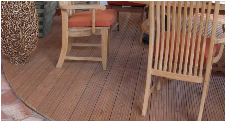
Abb. 1: Bei dieser Gestaltung einer Holzterrasse mit einer Einfassung (hier als Steinbelag) ist selbst bei großem Abstand der Dielen zum Untergrund eine ausreichende Belüftung nicht gegeben. Die Lebensdauer wird stark minimiert.
